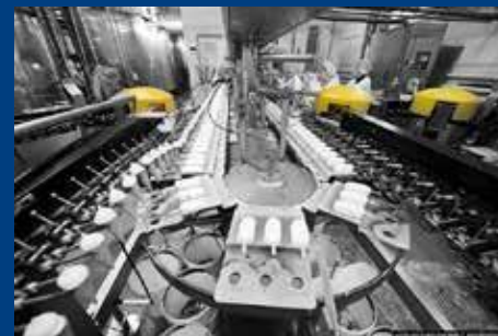
Installation de Transformation des Produits Congelés
